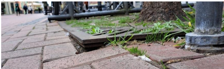
Unterschiedliches Setzungsverhalten zwischen Pflaster und Baumrost
