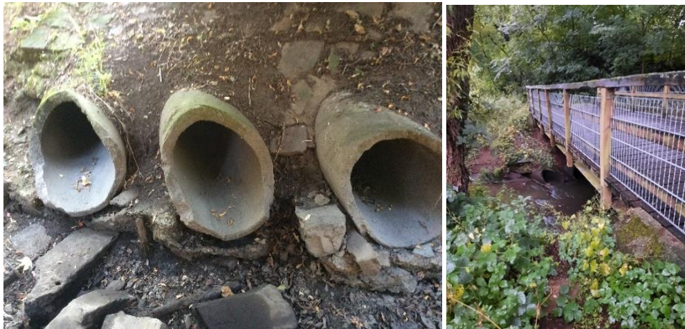
Bild 9 Einleitung DE-02-H (Brucherhof)
