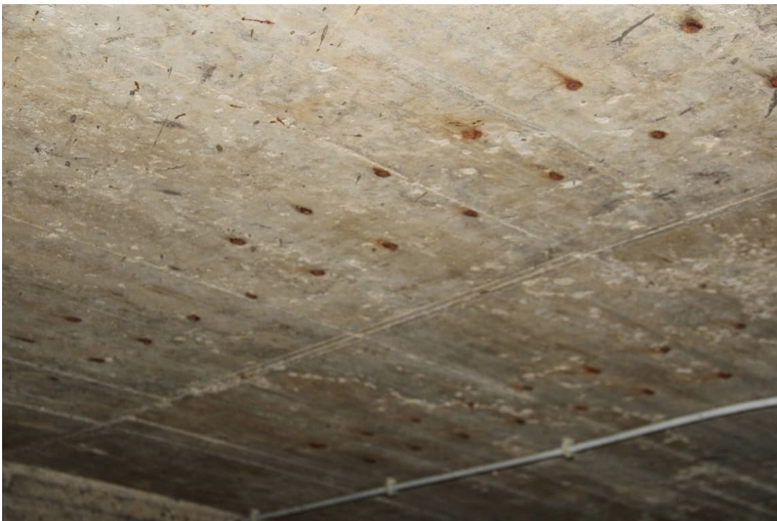
Abb. 5.5: Korrosionsflecken auf der Betonoberfläche
