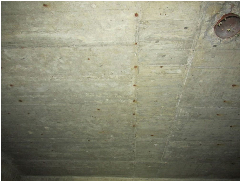
Abb. 5.18: Korrosionsflecken auf der Betonoberfläche
