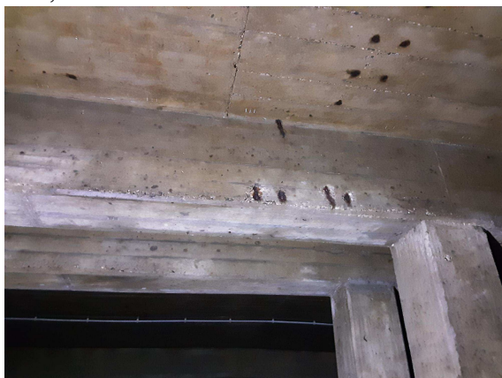
022 BETONABPLATZUNG MIT FREILIEGENDER BEWEHRUNG ACHSE 5
