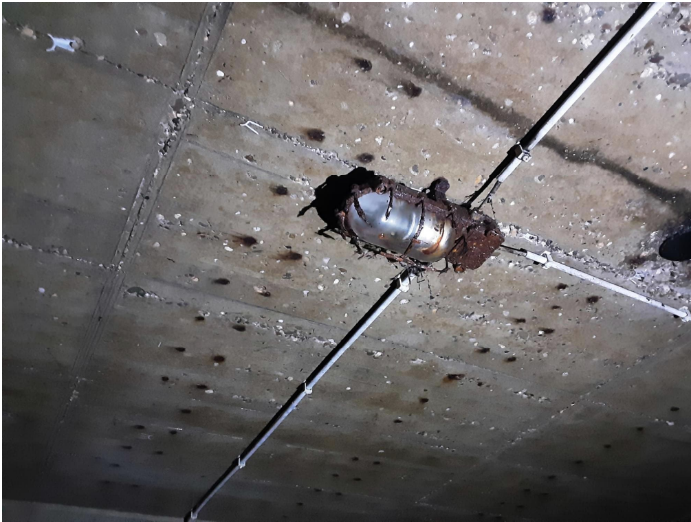
Abb. 5.16: Halterung der Beleuchtung korrodiert
