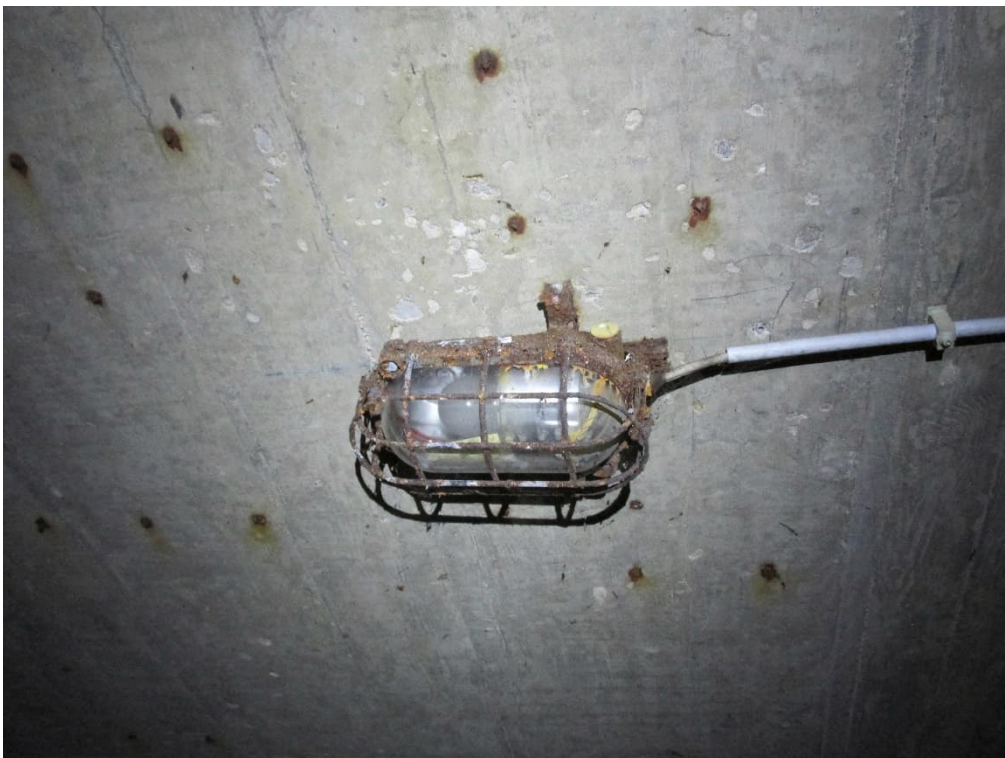
Abb. 5.20: Halterung der Beleuchtung korrodiert
