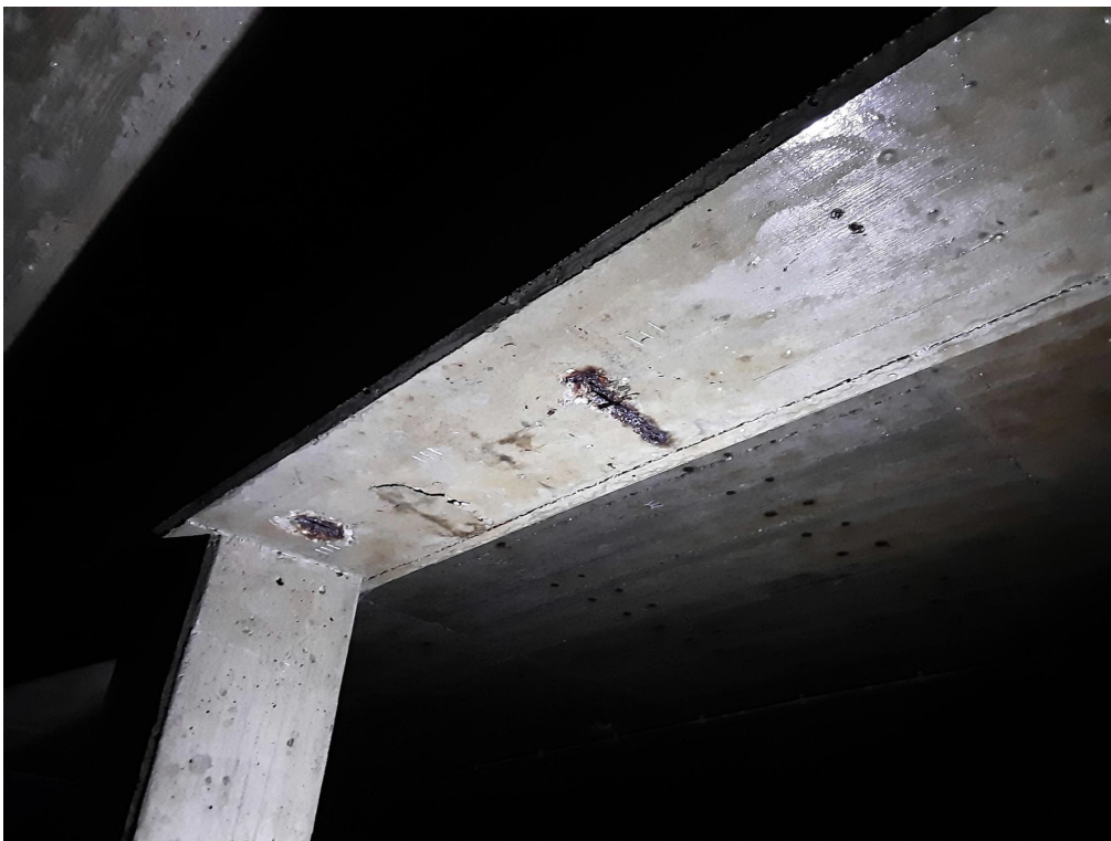
Abb. 5.7: Betonabplatzungen mit freiliegender Bewehrung an der Unterseite des Unterzuges (hier Achse 9)
