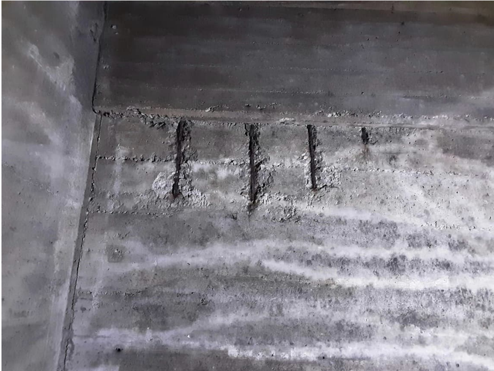
Abb. 5.13: Betonabplatzungen mit freiliegender Bewehrung
