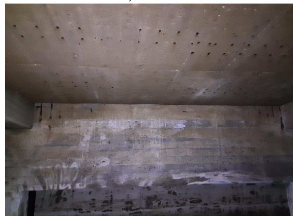
032 BETONAPLATZUNG MIT FREILIEGENDER BEWEHRUNG TAUCHWAND
