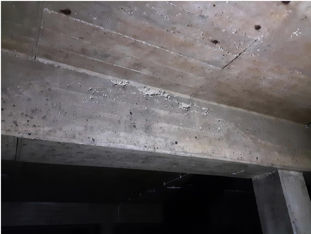
Abb. 5.6: Fehlstellen der Betonoberfläche (hier Achse 6)
