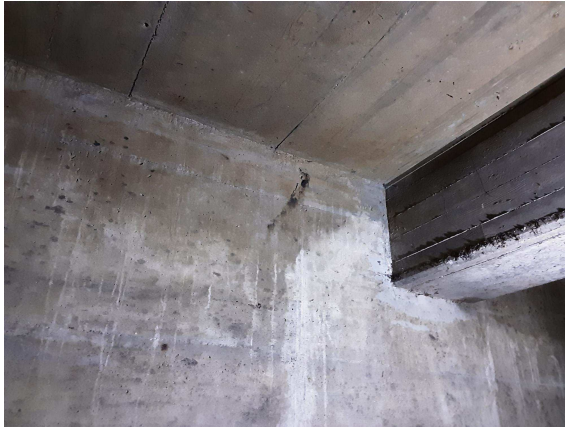
033 BETONAPLATZUNG MIT FREILIEGENDER BEWEHRUNG
