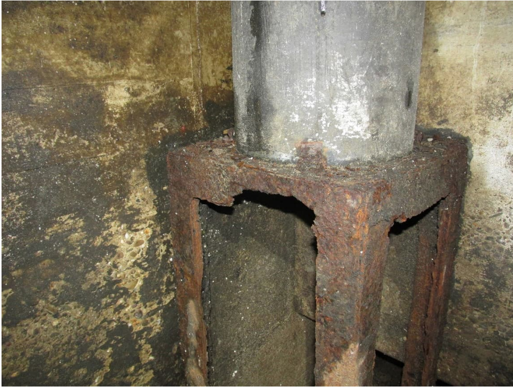
Abb. 5.21: Bauwerksausstattung sehr stark korrodiert
