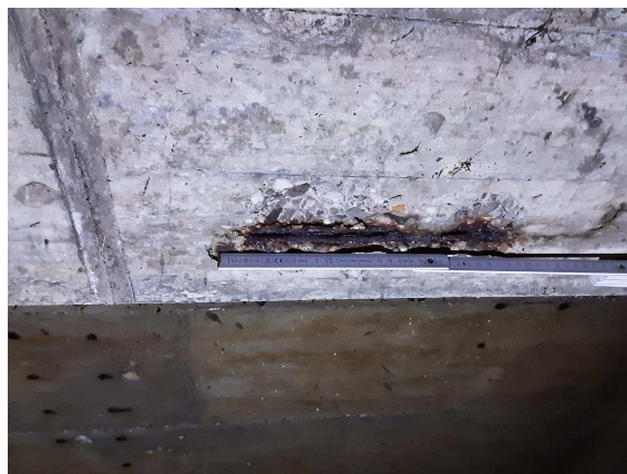
031 BETONABPLATZUNG MIT FREILIEGENDER BEWEHRUNG IN LÄNGSRICHTUNG
