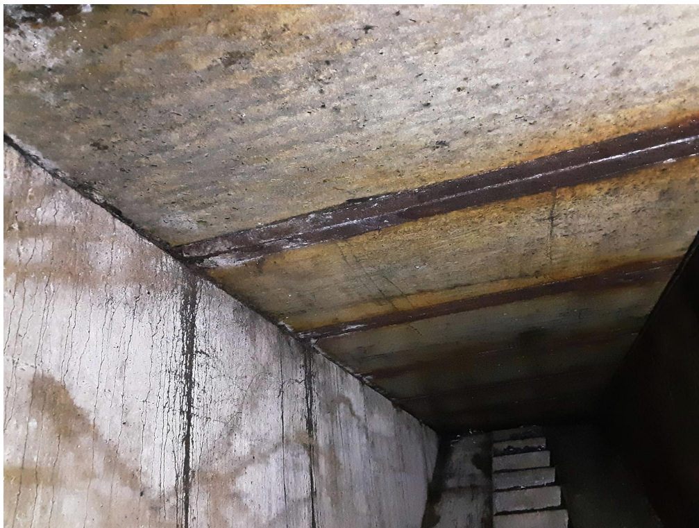
Abb. 5.11: Stahlteile der Schachtabdeckungen der Rampe korrodiert
