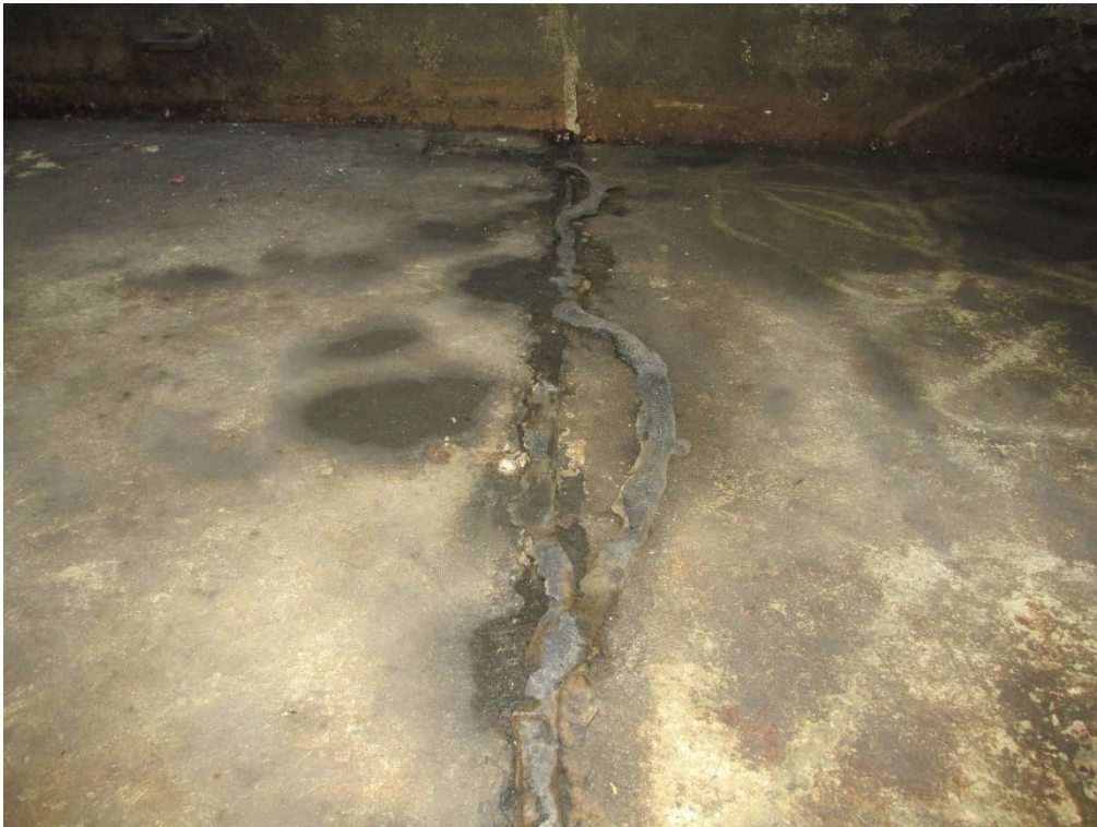
Abb. 5.14: Nicht mehr intakte Fugenabdichtung
