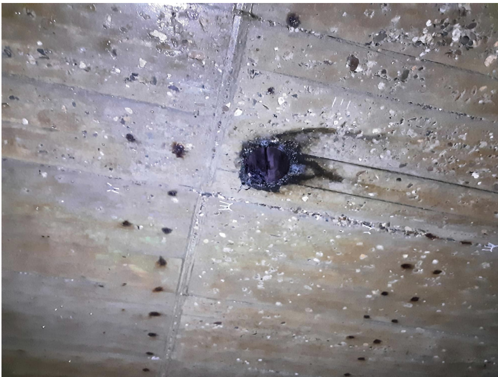
Abb. 5.15: Belüftungsöffnungen verstopft, nicht funktionsfähig
