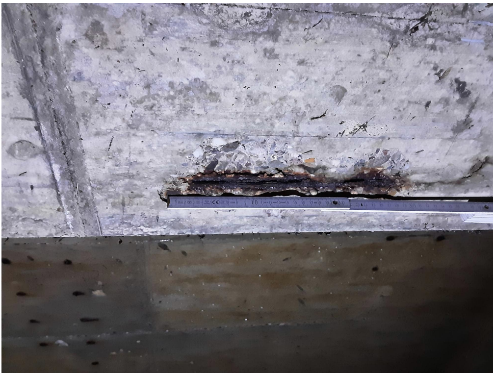
Abb. 5.9: Betonabplatzungen mit freiliegender Bewehrung
