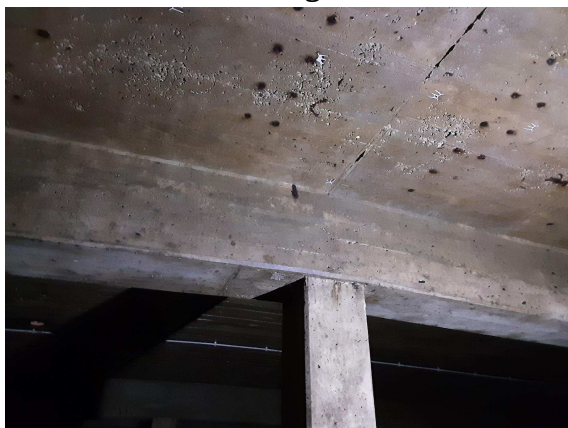
020 BETONABPLATZUNG MIT FREILIEGENDER BEWEHRUNG ACHSE 6
