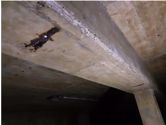
007 BETONABLATZUNG MIT FREILIEGENDER BEWEHRUNG
