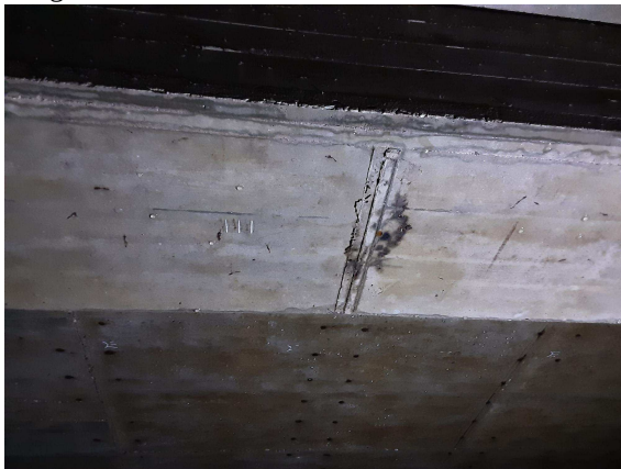
013 HOHLSTELLE MIT BEGINNENDE KORROSION
