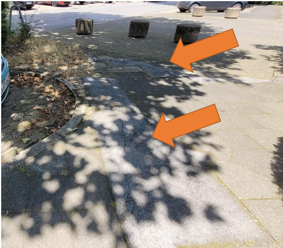
Schäden im Gehweg
