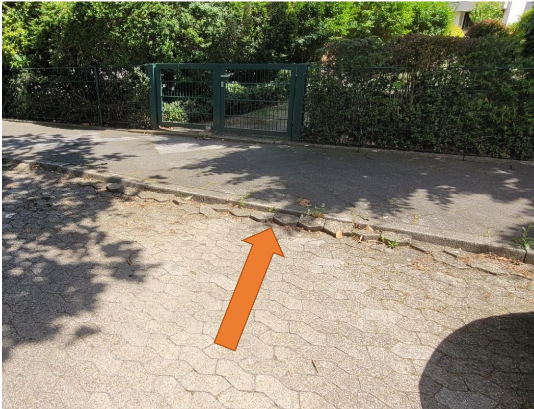
Schäden an Stellflächen
