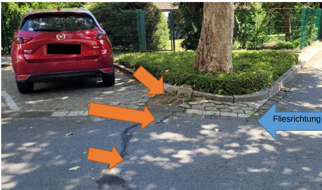
Schäden an Stellplatz, Abflussrinne und Straße
