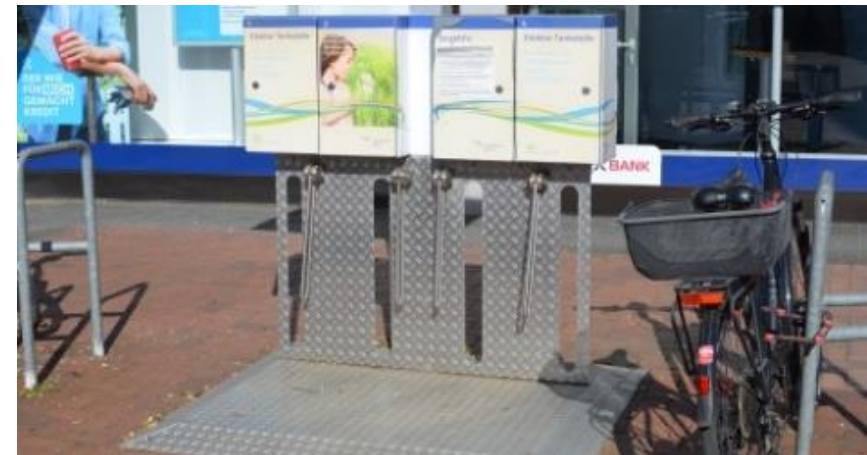
Abb. 2.5.7-3 E-Bike-Ladestation (eigene Aufnahme)
